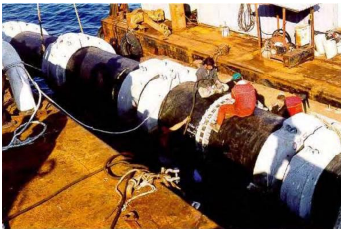
Рисунок 3 – Две секции трубы, закрепленные между собой при помощи фланцев
